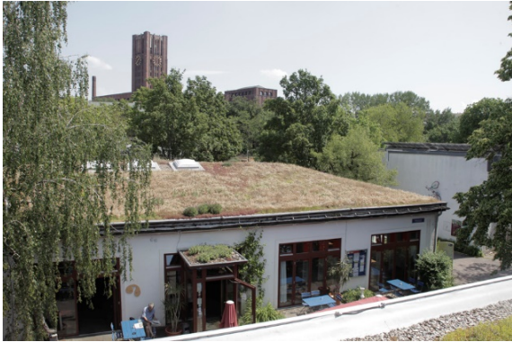
Das PV-System bietet auch Vorteile für die Vegetation
