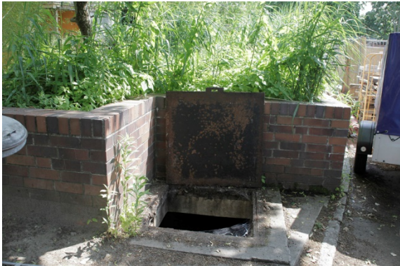
Zisterne der Regenwassernutzungsanlage
